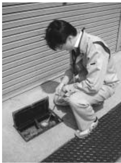
水道メータのバイロットマークの動きを見て漏水の有無を調査する職員
