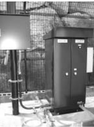
配水管末の水質監視設備
