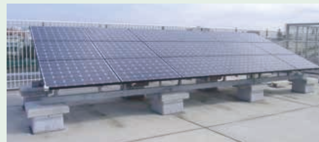
甲子園浜小学校の屋上の太陽光パネル
