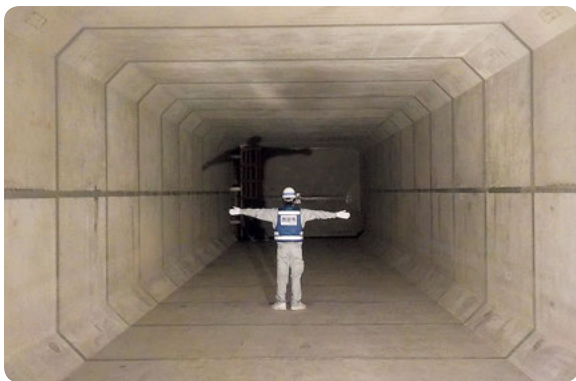
鳴尾駅前雨水調整池（内部）
