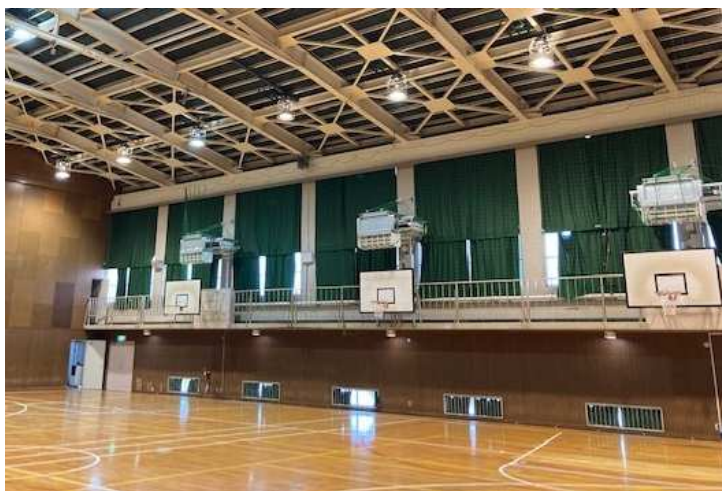
中学校に設置した体育館空調
