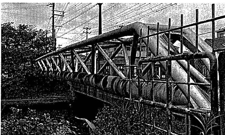
■新川水管橋。トラス型の補剛形式を採用している＝甲子園網引町
