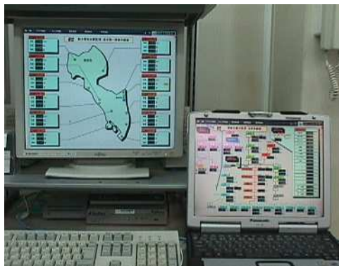
配水管末・受配水集中監視装置
