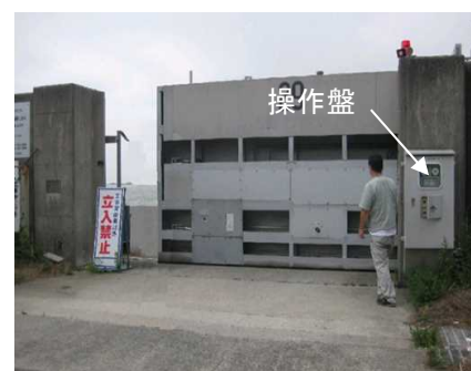
写真 5.4 陸閘の電動化（尼崎西宮芦屋港）
