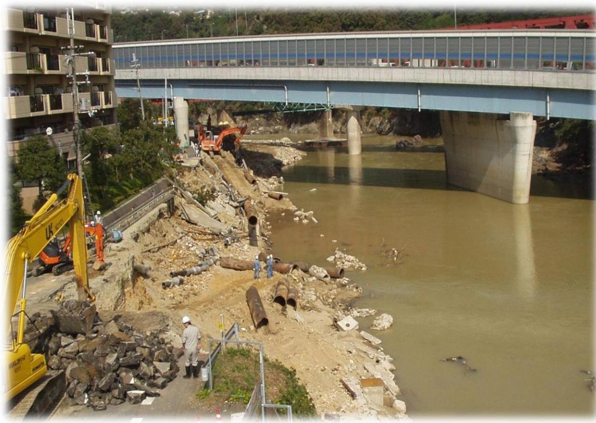
平成16年 台風第23号 西宮市内
