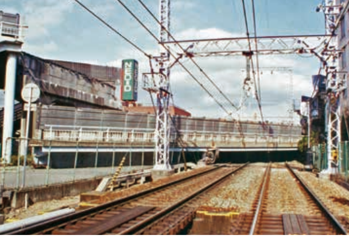
国道171号 門戸陸橋(野間町)／落ちた陸橋が線路を塞いでいます
