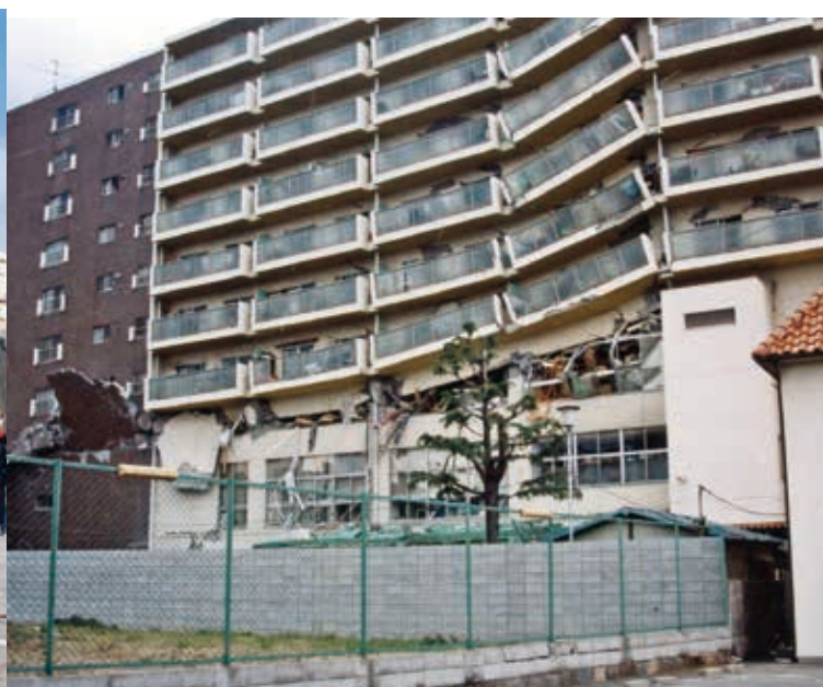
中階が潰れ、上の階が大きく歪んだマンション
