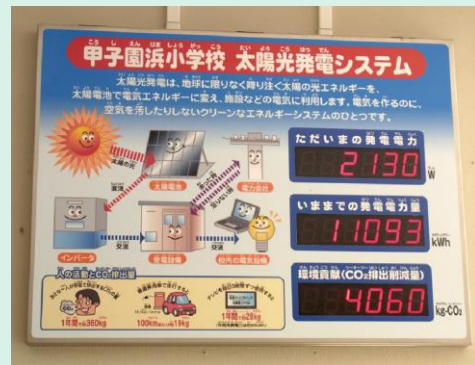
発電量のモニター
