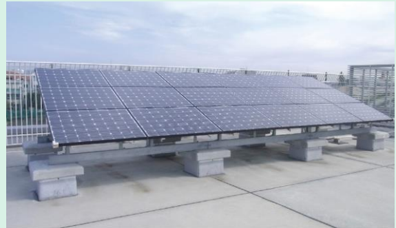
甲子園浜小学校の屋上の太陽光パネル
