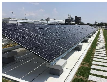
図1-6 香櫨園小学校の太陽光発電設備
