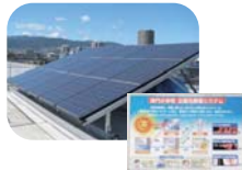
太陽光発電パネルと標示板（津門小学校）
