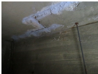
南棟 天井裏スラブ劣化部1
