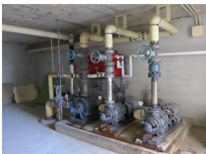
ポンプ室内全景
