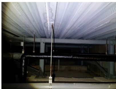
プールピット槽
