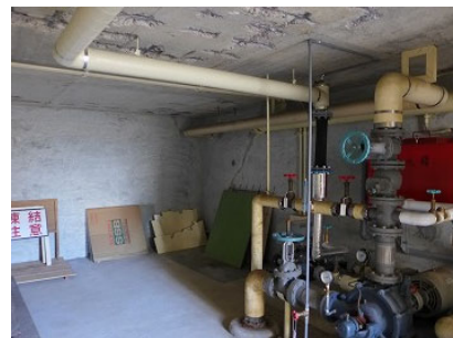
ポンプ室 内観
