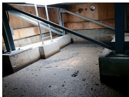
プールピット槽
