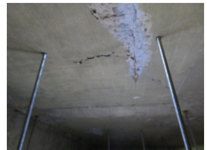
南棟 天井裏スラブ劣化部2
